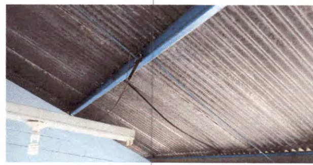
Foto 10: Sustrucción de ducto eléctrico + accesorios.
